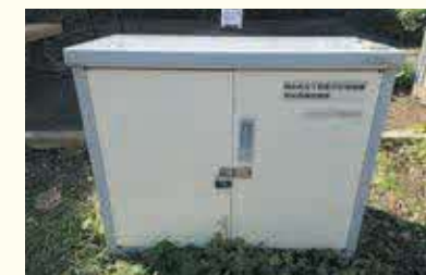
マンション敷地内に町会のスタンドパイプ格納庫を設置
